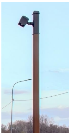
Опора освещения проезда
